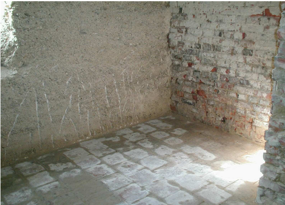
Abbildung: Feuchteschaden im Keller, sowohl bei Ziegel als auch bei Beton
